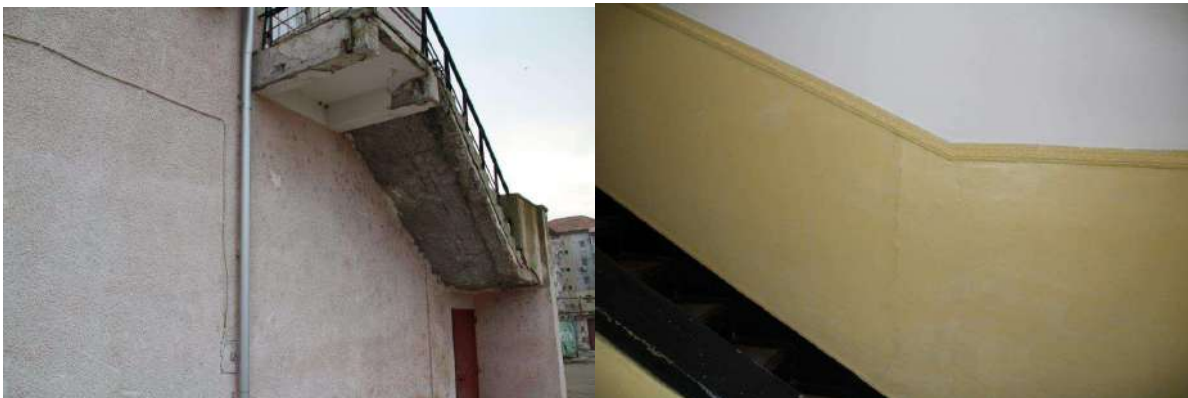
Fig 9 Clădirea actuală este întreținută deficitar și este vizibil deteriorată
